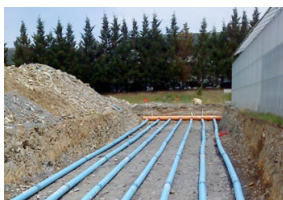
Rede de tubos para pozo canadense.
