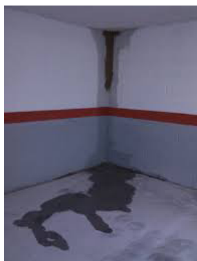
Aspecto do interior dun soto con lesións de humidade por infiltración.
