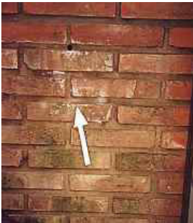
Manchas de eflorescencias en fábrica de ladrillo.
