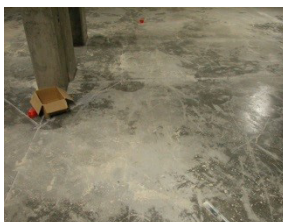
Aspecto do interior dunha soleira con lesións de humidade por ascenso capilar.
