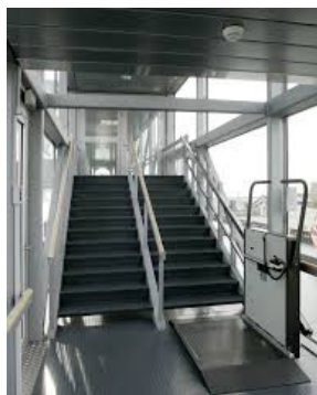
Un salvaescaleiras permite acceder desde o portal ao resto do edificio.
